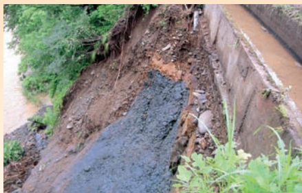
原堰用水路法面崩落【小平尾】
