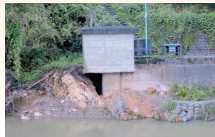
小出郷第2号頭首工の損傷【中家】
