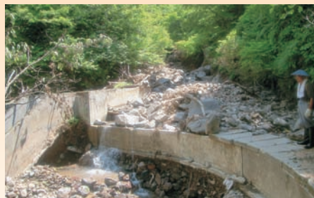
大松水路溝畔崩落【大倉】
