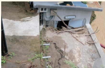
新下揚水機場の土砂流入【須原】
